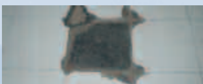
Dalles vinyle amiante dégradées
