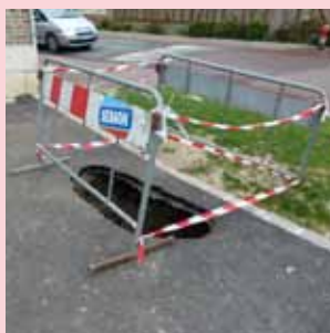
Un effondrement de la chaussée
